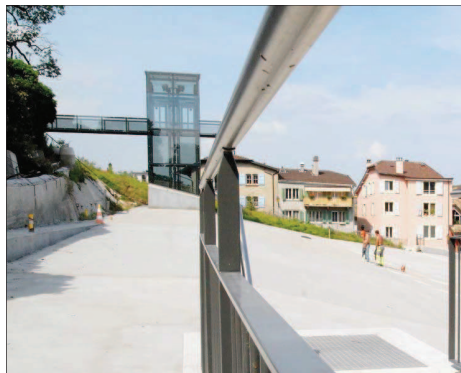
Les travaux sur la dalle du parking de la Duche ont démarré lundi matin. Ils seront terminés pour l'arrivée des touristes. Alexis Voellin
